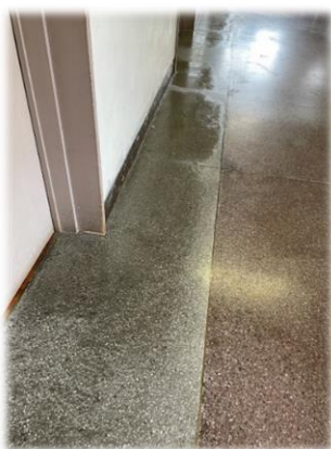
事務室前廊下は結露して光を反射しています。
